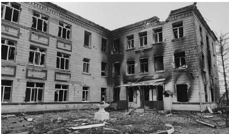
На фотографии здание больницы в г. Судже, разрушенное вооруженными силами Украины
